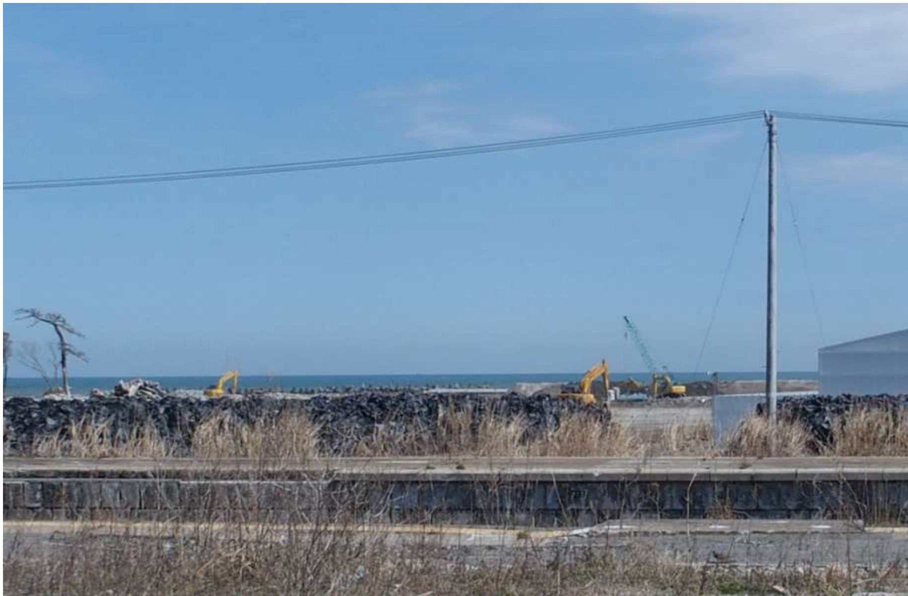
富岡駅の駅舎は取り壊され、プラットフォームらしきコンクリートが名残を留める。海岸線には似つかわしくないフレコンバックの山が延々と続く。
