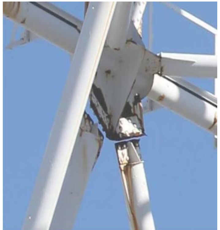
北側/支柱が2本とも破断している
